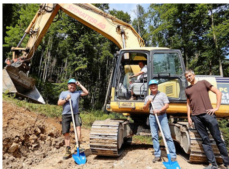
Gemeinde, Bürger, Ingenieure und Bauunternehmen: Für das neue Trinkwasserreservoir arbeiten alle Hand in Hand – und feierten gemeinsam den Spatenstich. Foto: Sibylle Hunziker
